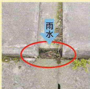
雨樋からの排水先に落ち葉や土砂が堆積している例
