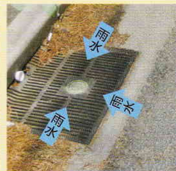
雨水で道路脇に落ち葉や土砂が堆積している例
