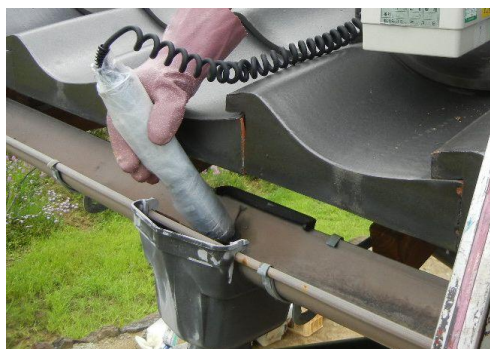
軒樋の集水器
