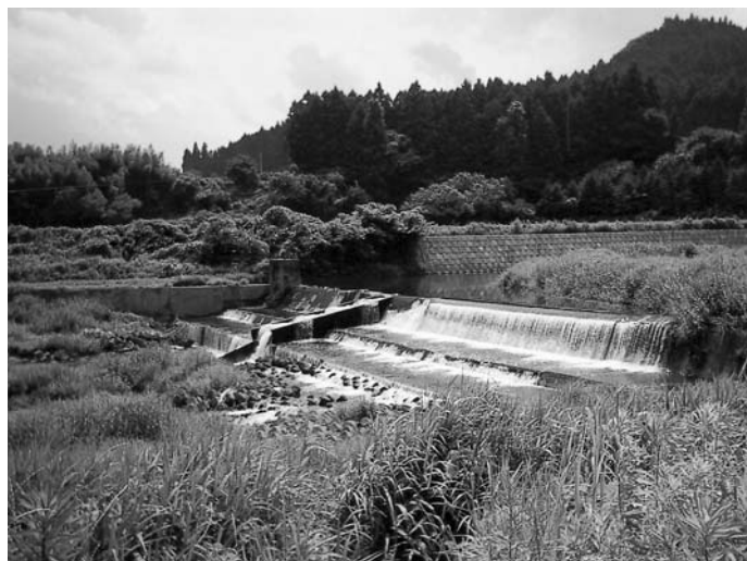
▲改修が待たれる老朽堰
