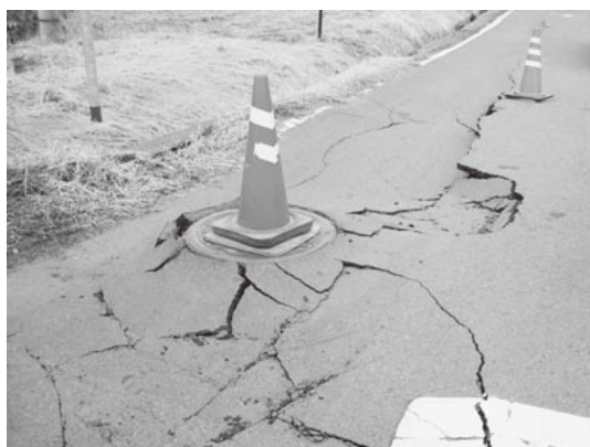
▲陥没した天王内地内の町道
