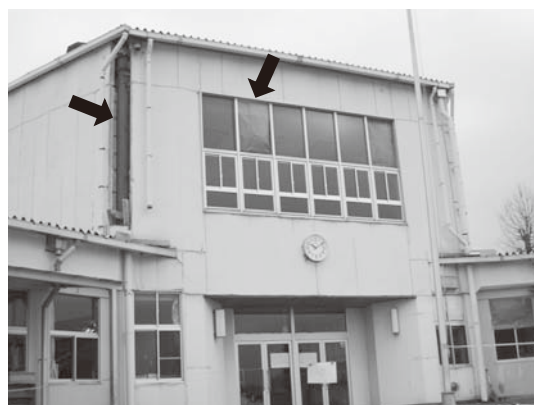
▲外壁や窓ガラスが破損した棚倉幼稚園
