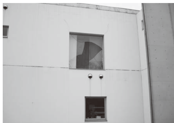
▲音響設備や窓ガラスが破損した町文化センター
