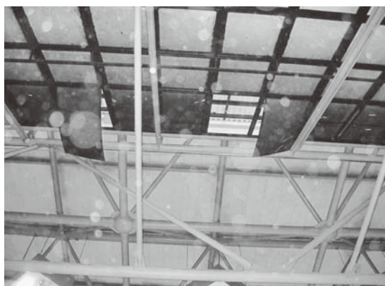
▲天井や窓ガラスが破損した町総合体育館
