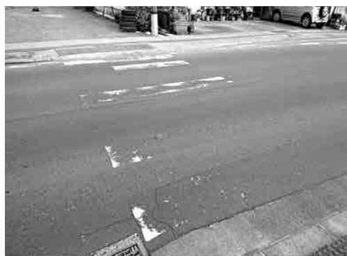
線が見えにくくなっている横断歩道
