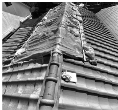
被災した家屋の屋根
