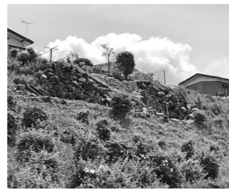
崩壊しているニノ丸石垣
