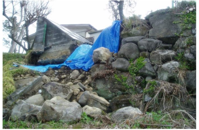
崩落した石垣の様子②
