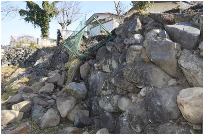
崩落した石垣の様子①
