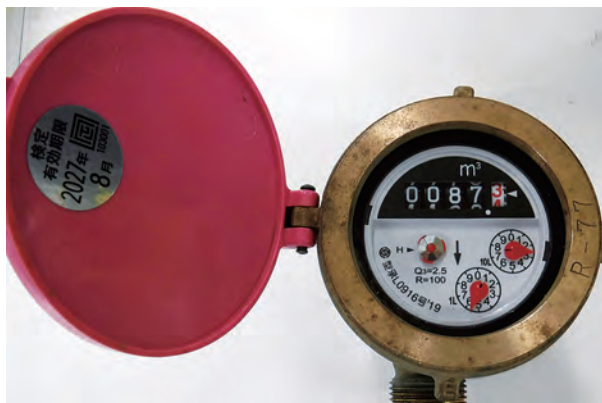
▲水道メーター
